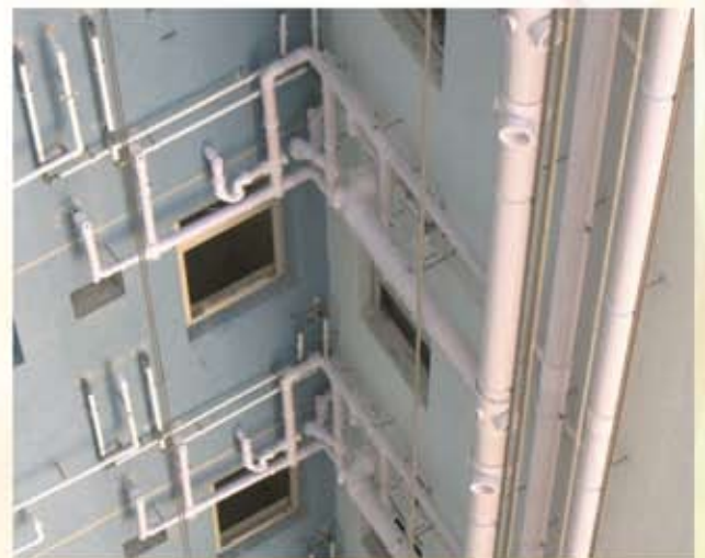
愛東邨公屋所有地台去水接駁反虹吸管道
